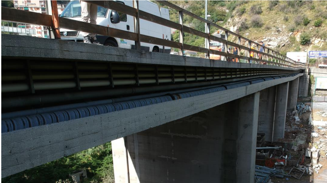
Figura 2: Vista dell'impalcato con evidenza degli effetti del cedimento fondazionale
