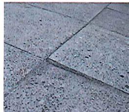
Avvallamento della pavimentazione
